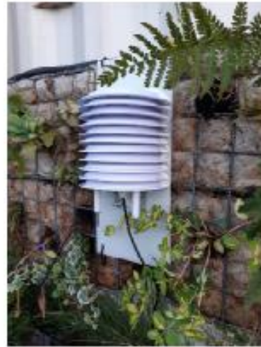
Figure 22 : Capteurs pour la paroi végétalisée
